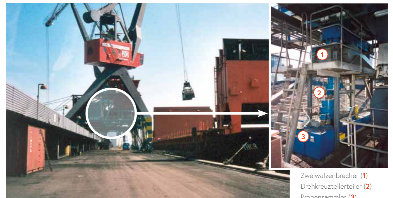
Probenahme im Entladekran für Kohle
