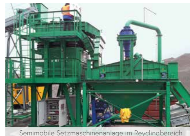
Semimobile Setzmaschinenanlage im Recyclingbereich
